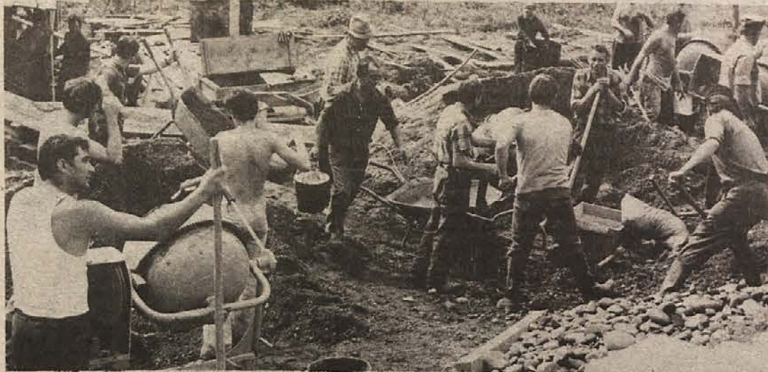
Takole živahno je bilo poleti na gradbišču Zdravstvene postaje v Osilnici. Prebivalci obeh strani Kolpe so lani na tem gradbišču delali prek 4.600 delovnih ur. (Foto: Rugole)
