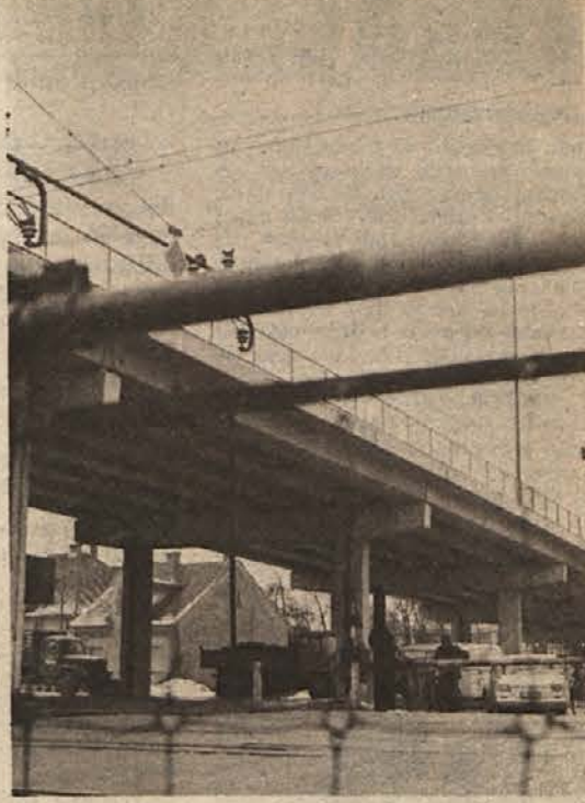
Novomeški Pionir nadaljuje gradnjo nadvoza nad železniško progo v Krškem, ki bo povezal most in cesto po najkrajši poti in se obenem izognil večno spuščeni zapornici. Zaporno plast asfalta bodo položili, ko bo dopuščalo vreme, in potlej fotografij čakajočih ne bo več...
