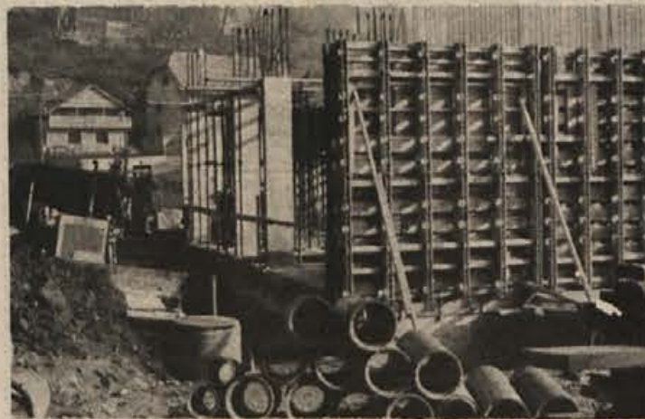
V Sodražici kar hitro raste nova poslovno-stanovanjska stavba. Razmeroma lepo vreme ugodno vpliva na gradnjo. (Foto: Primc)
