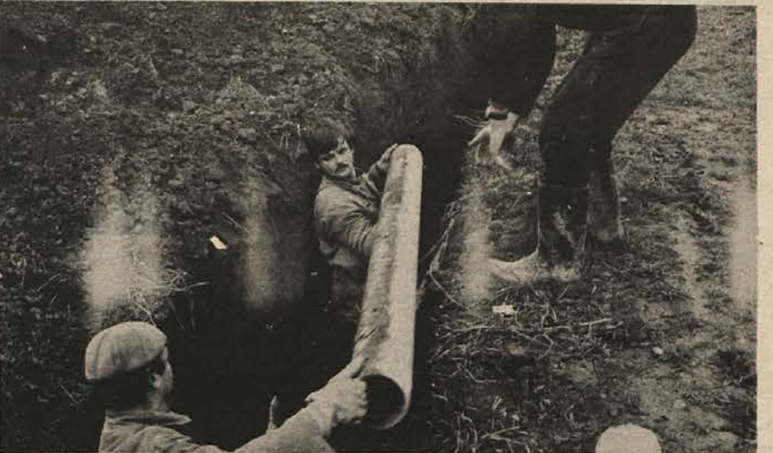
Vodovod proti Knežji vasi je v glavnem nared; ni posebnih ovir, da ne bi mogli nadaljevati tudi prot Dobrnjču. V to akcijo je vključen tudi del sredstev, ki se zbirajo solidarno s samopriskevkom občano vse občine. Na sliki: zaključna dela na glavnem vodovodu proti Knežji vasi.
