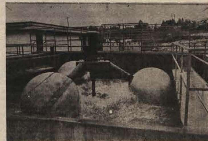
„KRKA“ ZA ČISTEJŠO KRKO. Del čistilnega bazena in naprave za mehansko razbijanje večjih delcev v odpadnih vodah. Trije „plavači“ vzbujajo posebno pozornost obiskovalcev...
