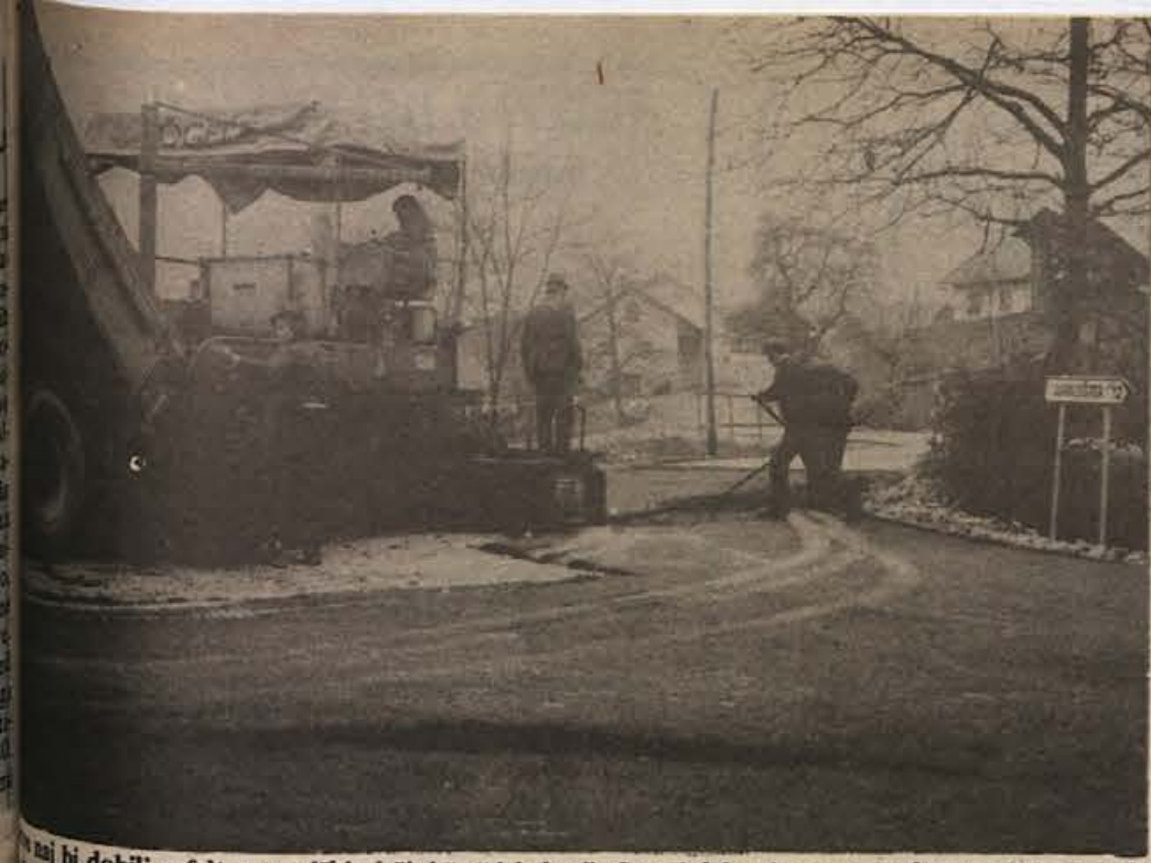
Kaj bi dobili asfalt v sevniški občini še štirje kraji. Cestni delavci so ga minuli četrtek že položili (na sliki), stroje so zatem prepeljali v Pijavice, od koder bodo šli še v Tržišče in na Brezovo. (Zeleznik)
