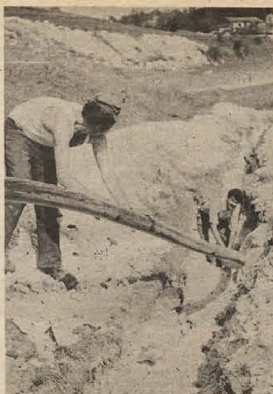
30. septembra so delavci novomeškega Vodovoda polagali vodovodne cevi do novega stanovanjskega naselja nad Stopičami; odkop in zasip jarkov so opravili prebivalci, prispevali pa bodo še po 3.000 dinarjev na gospodinjstvo. Stroške za kompresorska dela in miniranje je poravnala KS Stopiče. (Foto: Feliks Orel)
