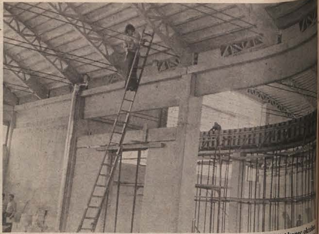
Poleg krškega Imperiala dokončujejo skladišča in proizvodne prostore, ki bodo vseljivi konec oktobra. Oboje sodi v okviru razvojnega programa, ki ga bodo uresničevali še v letih 1976 in 1977. (Foto: J. Teppey)
