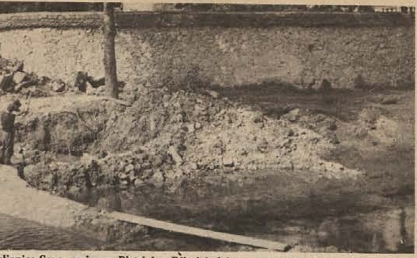
Vodna skupnost Ljubljana-Sava ureja na Bistrici v Ribnici dvizno zapornico. Letos bodo uredili temelje in delno še pregrado, prihodnje leto pa tudi mehanizirani del zapornice. Pravijo, da bo potem v Ribnici manjša nevarnost poplav. (Foto: Primc)
