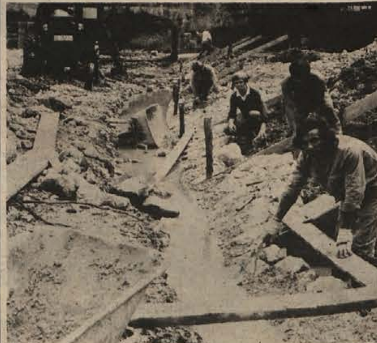
Reka je za Mirenčane vse manj nevarna, zakaj regulacijska dela, ki jih izvaja Splošna vodna skupnost Dolenjske nad starim mostom, dobro napredujejo. Tod je bilo ob nalivih pravo ozko grlo, a zdaj voda teče že po novi strugi, ki še ni popolnoma dodelana.
