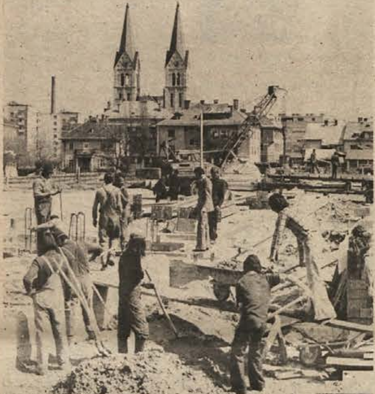
Glavna letošnja investicija krajevne skupnosti Kočevje je plavalni bazen in telovadnica, ki bosta pod isto streho, dograjena pa bosta jeseni. Dela, ki se financirajo predvsem iz samoprispevka občanov, zelo lepo napredujejo. (Foto: France Brus)
