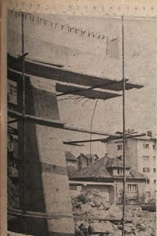
Stebri za nadvoz nad železniško progo v Krškem so zabetonirani. Z mostu čez Savo bo stekla po njih cesta in se po nasipu spustila mimo samskega doma do križišča. Nadvoz gradi gradbeno podjetje Pionir. Po njem se bomo vozili že v drugi polovici leta. (Foto: J. Teppey)
