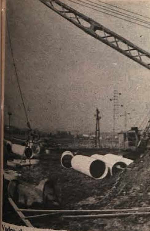
Vodna skupnost Dolenjske je pripeljala na polje za tovarno IMV v Breznicah težke stroje za izkop odvodnega kanala za novi predelovalni obrat Slovina v Brezini. Kanal bo dolg 1750 metrov. Investitor je Slovina in bo odšel zanj 2 milijona dinarjev. (Foto: J. Teppev)
