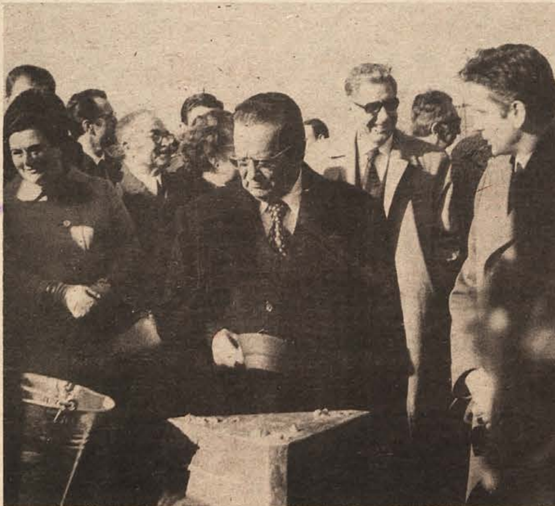
Zgodovinski trenutek na gradbišču jedrske elektrarne v Krškem. Predsednik republike Josip Broz-Tito vliva malto v steber, v katerega je zabetoniral temeljni kamen prve jedrske centrale v Jugoslaviji. (Foto: Jožica Teppey)
