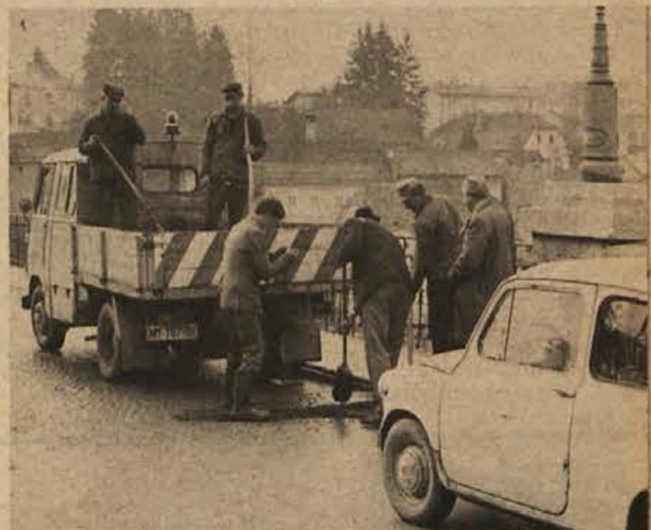
Križi in težave z novomeškim mostom se nadaljujejo in so taki prizori, kot jih kaže posnetek, malone že vsakdanji. A čimbolj si delavci cestnega podjetja prizadevajo zamašiti luknje, tem več je novih, ki jih „izvrtajo“ prometne reke.
