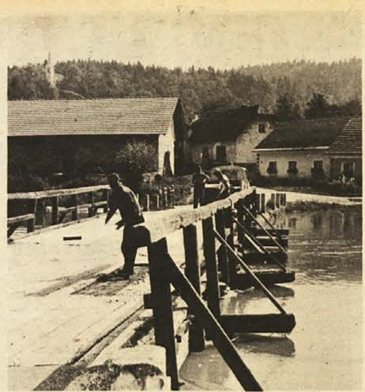
Do mosta pri Meniški vasi je prejšnji teden spet pridrla voda. Ker se večkrat dogaja da je most pod vodo, je tudi večkrat potreben popravi. Dotrajane deske so zdaj spet zamenjali. (Foto: R. Bačer)
