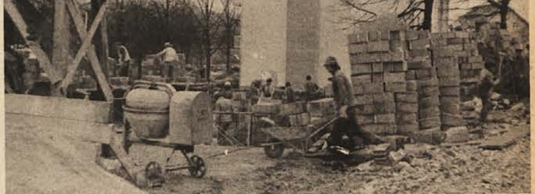
Delavci „TGP“ so pričeli graditi poleg dveh stanovanjskih blokov, ki sta že pod streho, še tretjega... (Foto: B. Podobnik)
