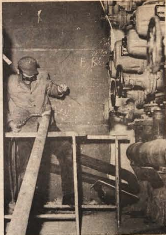
V sredo, 16. januarja, so v stari šolski stavbi v Kočevju prostore prvič ogrevali s centralnim ogrevanjem. Doslej je bilo v tej šoli kurjenje z drvmi (ki so jih običajno, namesto da bi imeli telovadbo, skladali v drvarnice učenci.) (Foto: F. Brus)
