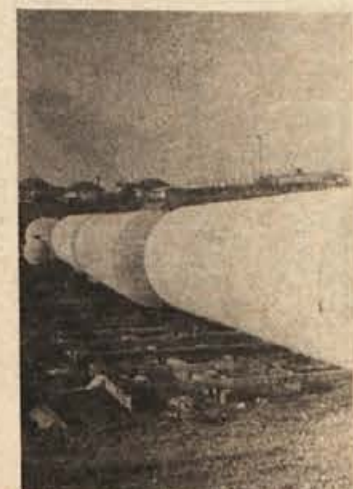
Gradbišče za novo bencinsko črpalko v Brežicah. Čez pol leta bodo na križišču cest Brežice - Čatež in Brežice - Dobova, točili bencin (Foto: J. Teppey)
