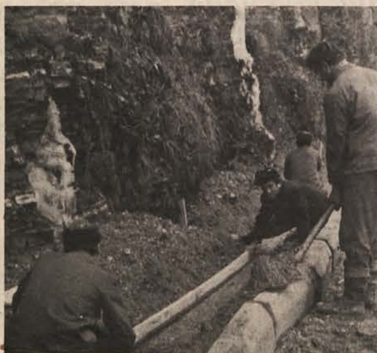
Na cesti Impoljca - Krško. Mila zima je kot naročena za delavce cestnega podjetja. Na sliki je odsek pri Pijavskem, kjer je bila graditev ceste zelo zahtevna in nevarna. Odstraniti so morali okrog deset tisoč kubikov kamna z 20 metrov visoke stene. (Foto J. Teppey)
