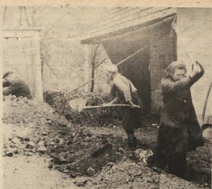
Pri delu na vodovodu v Češnjicah pri Trebelnem ni predaha: prizor smo posneli minuli petek. Dokler je vreme za taka dela še ugodno, ljudje hitijo s kopanjem jarkov do posameznih hiš. (Foto: Zelednik)
