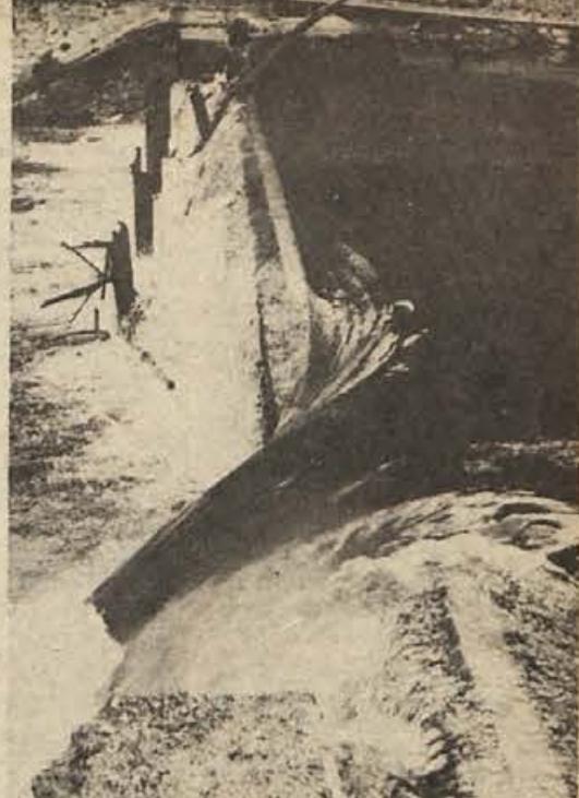
Ob zadnjih poplavah je Mirna močno zdelala jez v Boštanj, uničujoča moč vode pa je še na delu, ker se nihče ne spomni, da bi dvignil zapornice in zmanjšal pritisk vode na to, kar je še ostalo. V nevarnosti je tudi kopalnice, ki so ga uredili lani. (Foto: Železnik)
