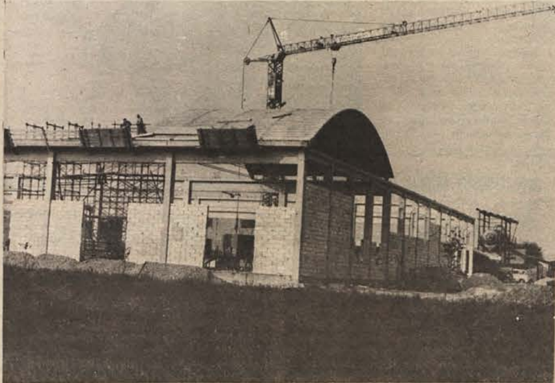
Gradbišče novih vinarskih objektov v Brežicah, ki jih gradi Slovin TOZD Brežice. (Foto: M. Vesel)
