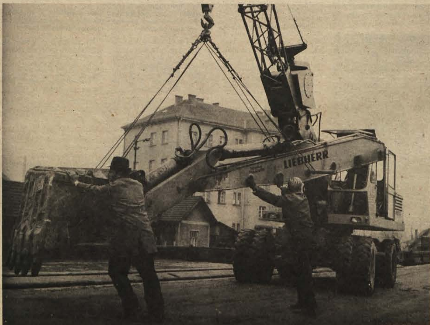
Prvi transporti mehanizacije in druge opreme, ki jo bodo Pionirjevi gradbinci potrebovali na gradbišču na Poljskem, so že odposlali iz Novega mesta. Odšla je tudi skupina delavcev, ki bo pripravila gradbišče in začela z zemeljskimi deli.
