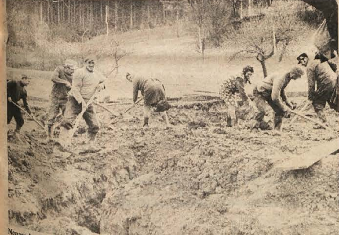
Nenavadno mila zima, predvsem borna, kar se snežne odeje tiče, je podaljšala „gradbeno sezono“ vaških skupnosti. Ljudje skušajo seveda takšno vreme obrniti sebi v prid, spomladi bo svoje terjalo polje. Takole so pred dobrim tednom dni hiteli zakopavati vodovodne cevi vaščani Smarčne, ki gradijo složno s Kompoljčani velik vodovod (Foto: Železnik)
