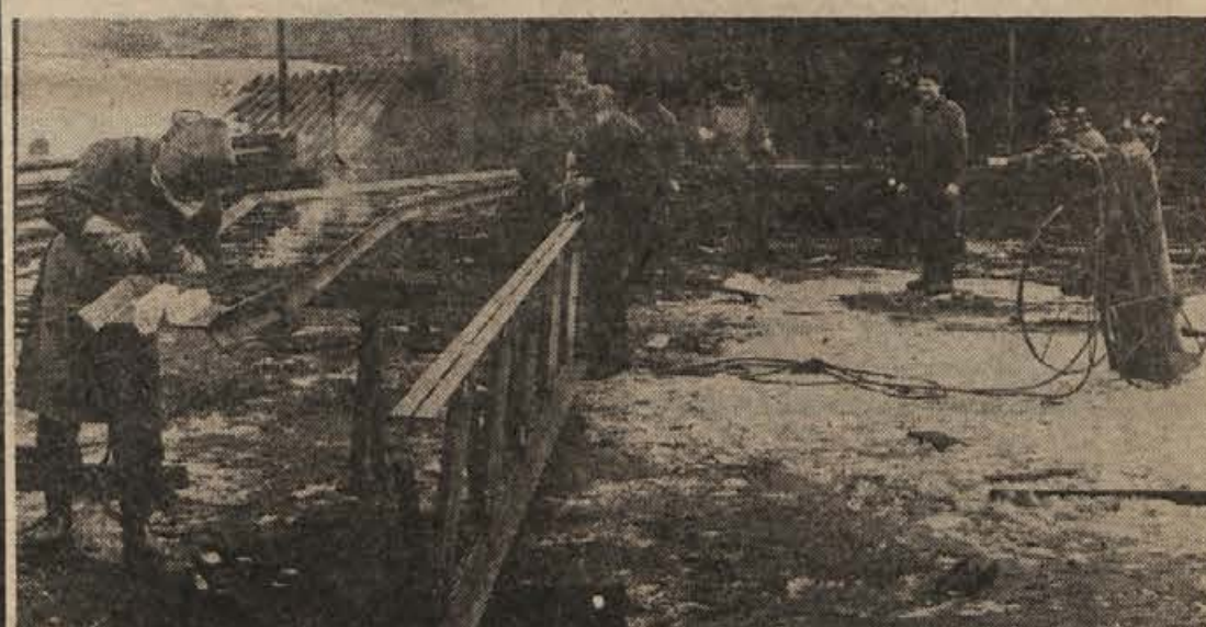
Konstrukcije so težko in naporno delo, še težja pa je njihova montaža, zlasti kadar kovinarjem nagaja vreme
