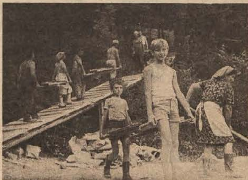
KADAR JE TREBA, PRIMEJO VSI — V straški krajevni skupnosti se tudi lahko pohvalijo z bogato komunalno dejavnostjo. Na sliki: občani Dolnje Straže pri gradnji rezervoarja za svoj vodovod, za delo so prijeli stari in mladi; kadar je treba, primejo vsi!
