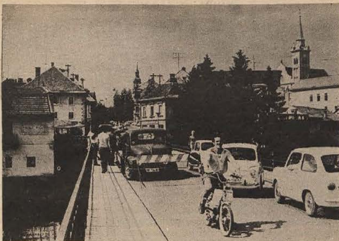
Na novomeškem potniškem mostu je bila pretekli četrtek in petek velika prometna stiska zaradi velike zevajoče luknje na mostu, ki je zahtevala zoženje cestišča. Najhujše je bilo v petek med 14. in 15. uro, ko so v največji prometni konici popravljali most. Ni nam razumljivo, kako to, da se napaka ni dala odstraniti ponoči, ko je manj prometa. Na sliki: prometni vrvež, ki ga je spremljalo hupanje avtomobilskih siren, je bil največji po končanem delu ob 14. uri. (Foto: S. Dokl)
