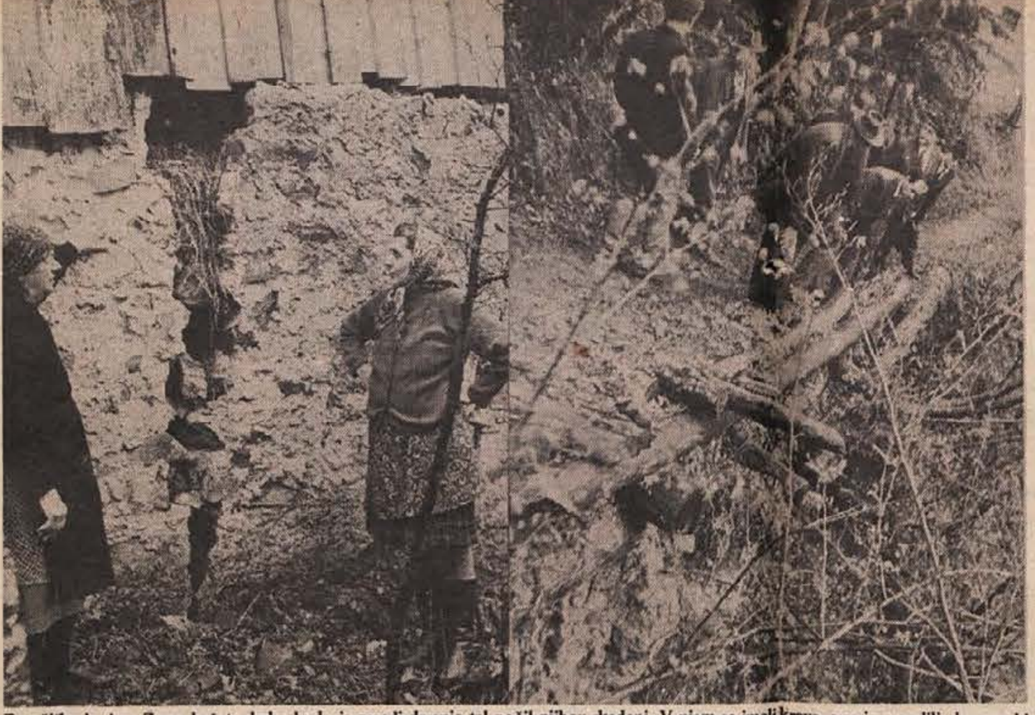
Franciška in Ana Zagar kažeta, kako hudo je zaradi drsenja tal počil njihov skedenj. V njem so imeli kravo, a so jo preselili, da se ne bi skedenj zrušil nanjo (slika levo). Občinski mošnje in Podplaninci gledajo, kje je v prepad odneslo del vznožja poti. (Foto: Jože Primc).
