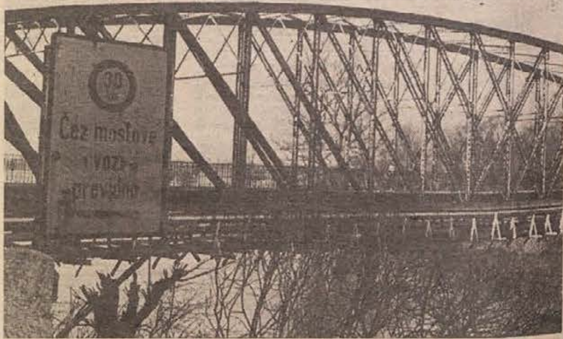
Pod brežiškim mostom so napeljali cevi za bodoči vodovodni rezervoar na Čatežu. Opešani stari most je tako prevzel nase novo breme. Vendar to v primerjavi s prometnim vrvežem ni prehudo. Sicer pa ga bo čez dve leti že razbremenil novi železobetonski orjak pod izlivom Krke v Savo. (Foto: J. Teppey)
