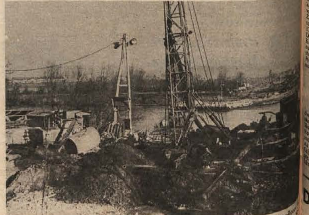
Del gradbišča za novi brežiški most na desnem bregu Save pri Budiču. Stroj za vrtanje pilotov bodo po znižanju vodne gladine prestavili na pontone, da bo nadaljeval delo v strugi. Del gradbišča za novi brežiški most na desnem bregu Save pri Budiču. Stroj za vrtanje pilotov bodo po znižanju vodne gladine prestavili na pontone, da bo nadaljeval delo v strugi. Del gradbišča za novi brežiški most na desnem bregu Save pri Budiču. Stroj za vrtanje pilotov bodo po znižanju vodne gladine prestavili na pontone, da bo nadaljeval delo v strugi. (Foto: Jožica Teppey)
