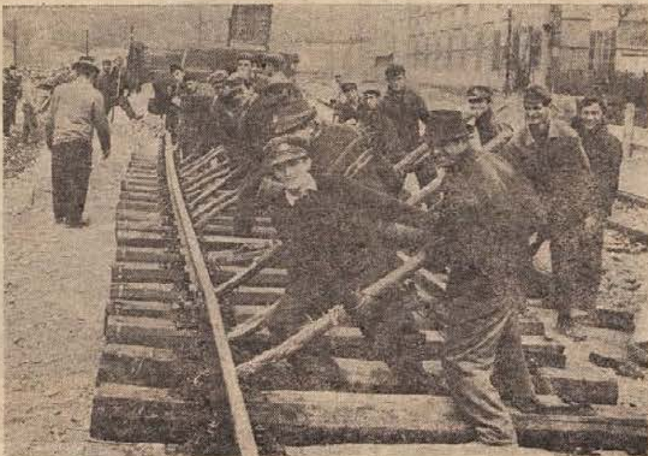
Prestavljanje tirov in druga zemeljska dela na postajnem območju v Krškem bodo zagotovo dokončana do 29. novembra, z napeljavo pa najbrže ne bo šlo vse gladko. (Foto: Jožica Teppey)
