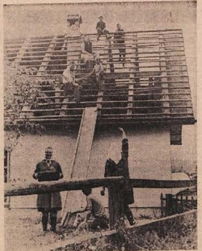
Prejšnji teden so Pionirjevi delavci razkrili in porušili hišo poleg sejnišča ob Cesti herojev v Novem mestu, ker bo ta prostor zavzela bencinska črpalka, za katero tudi že opravljajo zemeljska dela. Sejmišče bo podjetje DOMINVEST v kratkem prestavilo na Cikavo na desni breg Krke (Foto: Ivan Zoran)
