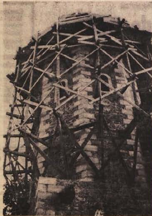
Na zvoniku cerkve v kosanjeviškem gradu so začeli postavljati konstrukcijo za 16,5 metra visoko kupolo (Foto: Jožica Teppy)
