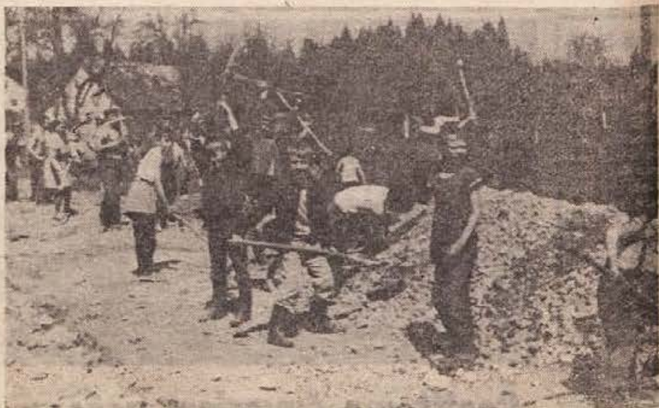
Občani Klinje vasi pri Kočevju popravljajo 2600 m dolgo cesto Gorenje-Klinje vas-Zeljnc, ki je zelo slaba. Prostovoljnega dela se udeležuje okoli 40 vaščanov. Kmetijsko gozdarsko posestvo, ki to cesto tudi uporablja, je obljubilo, da bo napeljalo potrebni material, občinska skupščina pa bo delno prispevala za vzdrževanje te ceste (cestarja, pozimi pluzenje itd.). Vlado Zivkovič, ki v imenu krajevne skupnosti Rudnik ta dela vodi, je povedal, da bodo dela kmalu končana. (Foto: Prime)
