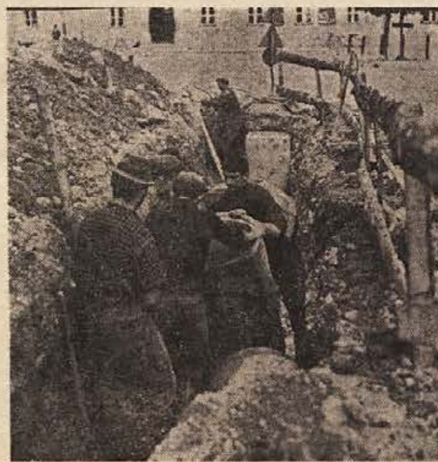
Pri izkopu jarka za vodovod v Sentjerneju je bagerist podrl precejšen del kanalizacije in so jo morali takoj popraviti. (Foto: P. Miklič)
