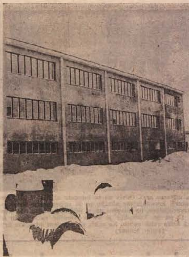
Nova proizvodna hala beltovega mehanskega obrata je že zgrajena, le obrtniška dela v upravnih prostorih (na sliki) še niso končana. (Foto: R. Bačer)
