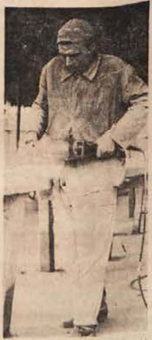
Na tržnici v Brežicah so postavili trajne stojnice. Betonske plošče obdelujejo te dni teracerji. (Foto: Jožica Teppey)
