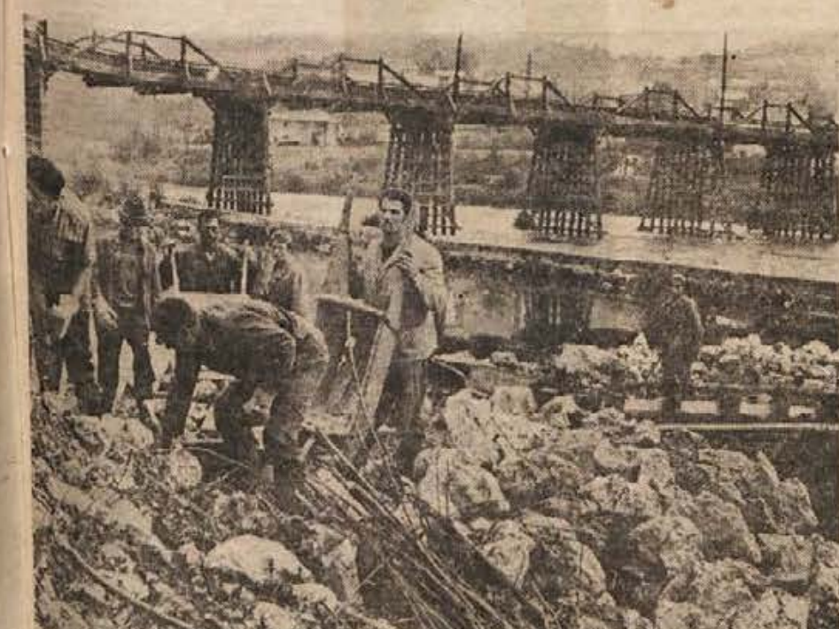
Levi breg Save je zavarovan, zdaj utrjujejo še desno obrežje. Delavci polagajo tonjače štiri metre globoko, nato zabijejo pilote, navozijo skale ter vse skupaj obtežijo z velikimi kvadri. Za utrjevanje brežine je vodna skupnost dala 500.000 din. (Foto: J. Tepcy)
