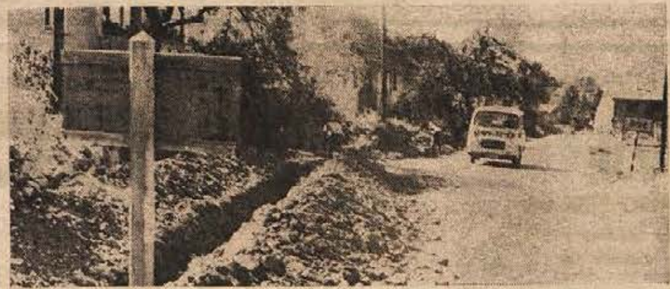
Delavci novomeškega komunalnega podjetja kopljejo jarek za vodovod Irča vas—Brod, za katerega plačujejo vaščani samoprispevek. Potrebno bo izkopati nekaj več kot 1.000 m dolg jarek za glavni vodovod, jarke za priključke pa bodo izkopali sami prebivalci. Na sliki: izkop jarka ob cesti pred nekdanjo Koširjevo gostilno na Brodu (Foto: Ivan Zoran)
