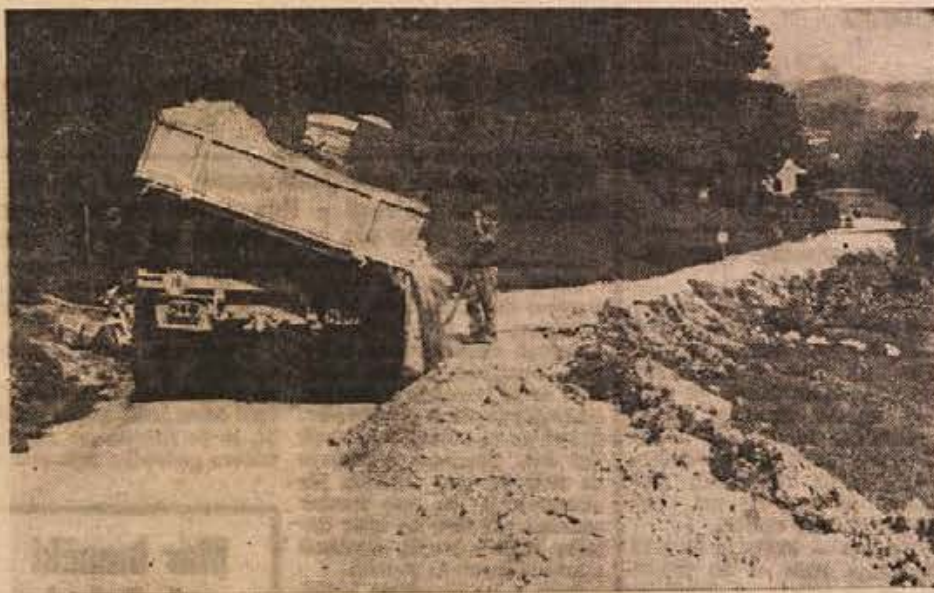
Prvi kilometer škocjanske ceste so delavci novomeškega Cestnega podjetja položili 13. in 14. septembra, če bo vse po sreči, pa bo cesta v celoti asfaltirana še v tem tednu. Dela hitro napredujejo. Preden cesto asfaltirajo, morajo napraviti dobro podlago. Na sliki: s tovornjaka stresajo material za podlago. (Foto: Polde Miklič)
