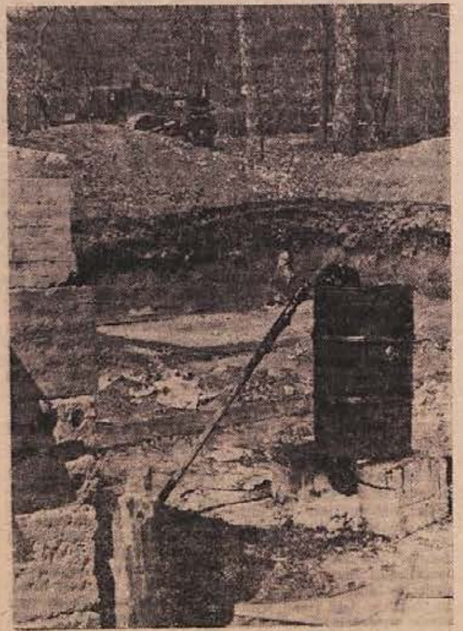
ZAMRZNJENA ČRNA GRADNJA in buldozer za stršilo! Še pri tistih redkih črnih gradnjah, ki bi morale biti porušene ali zasute je težko odločiti na čigavi strani je pravica. Občina in zakon imata prav brezdvomno, graditelj pa tudi dokazuje svoj prav, če ne drugače pa z dobrimi zvezami! Skoda, ki jo pri tem trpimo vsi, pa ni opravičljiva!
