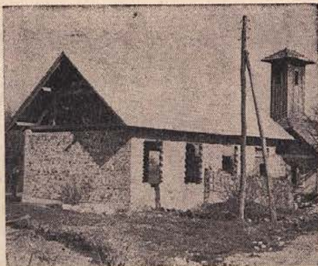
OREHOVIČANI NA POL POTI — Dvorana družbenih organizacij na Orehoviču sameva na pol zgrajena in čaka na boljše dni. Ali bodo vsa prizadevanja nekaterih požrtvovalnih občanov v KS Orehoviča zaman? (Foto: S. Dold)
