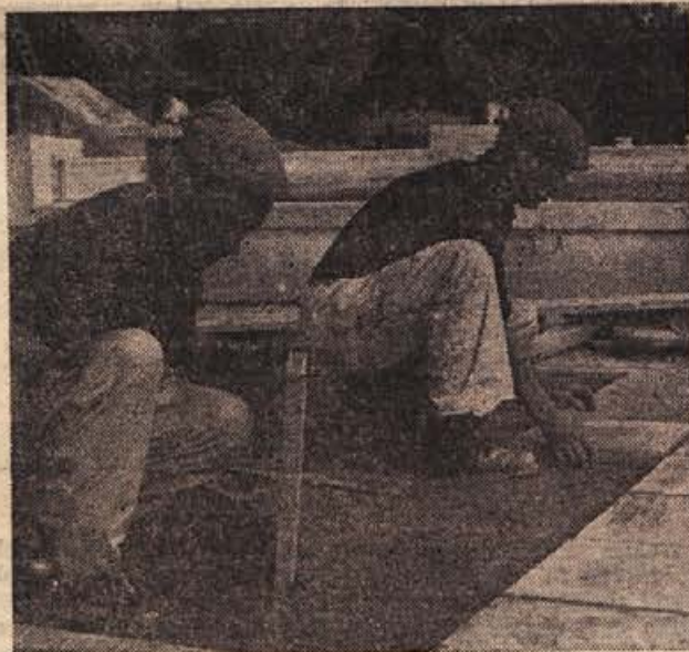
Zaključna opravila ob novem čateškem bazenu. Pas ob kopalnišču tlakujejo delavci z betonskimi ploščami. Bazeni bodo prebarvali ta teden. Za poskus so ga že napolnili z vodo. (Foto: Jožica Teppey)
