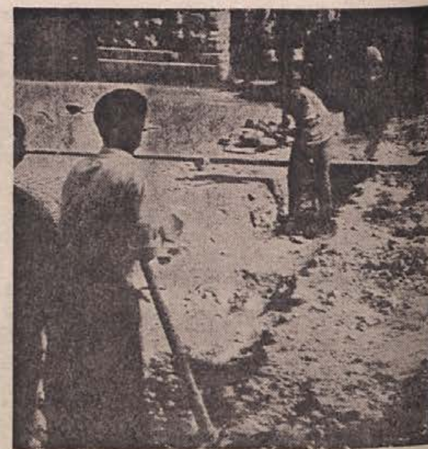
Predzadnji prekop ceste v Kočevju zaradi 10 kilovoltne kableske zanke je bil opravljen na Trgu svobode. Zadnjič pa bodo zaradi krožnega napajanja Kočevja z elektriko prekopali cesto pri Roškem mostu. (Foto: Prime)
