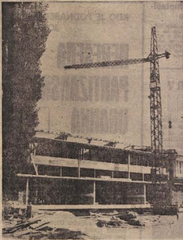
Gradnja trakta C nove kočevske osemletke lepo napreduje. Financirajo jo kočevske delovne organizacije, žal pa denar za gradnjo doteka nekoliko prepočasno. Tudi trakt C, ki bo predvidoma dokončan prihodnje leto, gradi kočevsko podjetje »Zidar«. (Foto: Prime)
