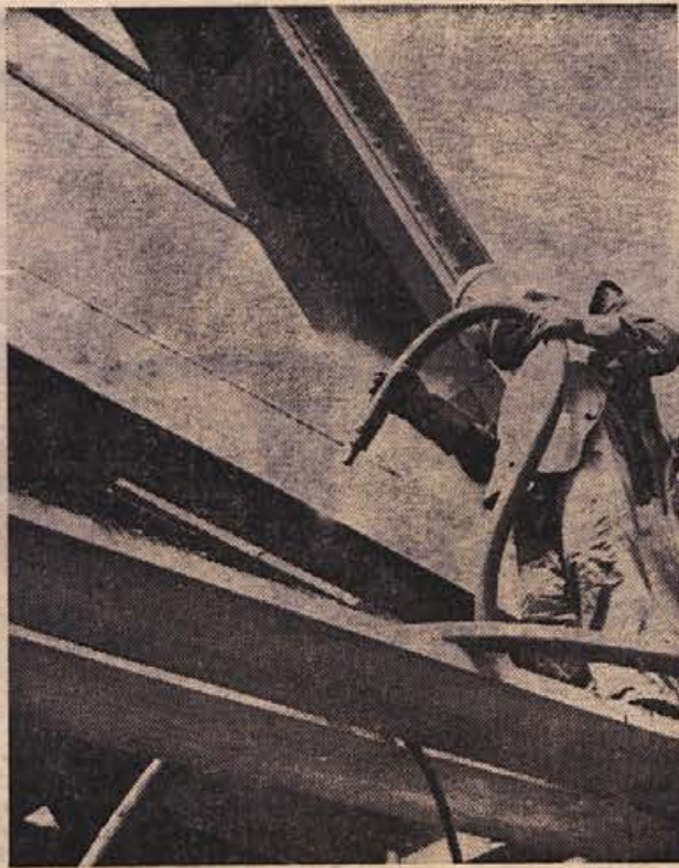
Sevniski železniški most čez Savo bodo na novo preplekali. Pred nekaj dnevi so že zaprli prehod za pešce in začeli odstranjevati staro barvo. Za to delo uporabljajo poseben stroj: človek, ki mu streže, je oblečen v obleko podobno onim z vesoljskih potovanj. (Foto: M. Legan)
