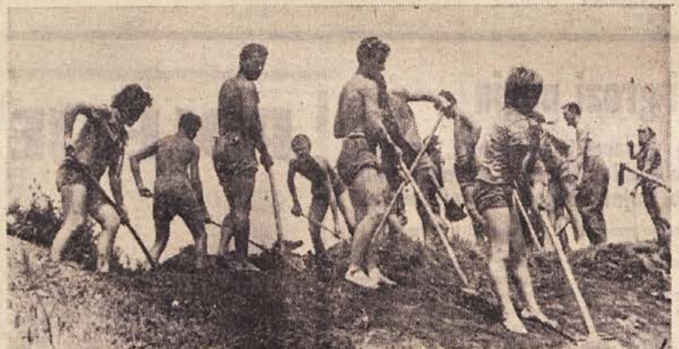
Brigadirji v Beli krajini so se te dni zamenjali, delo na cesti med Metliko in Črnomljem pa razveselivo napreduje
