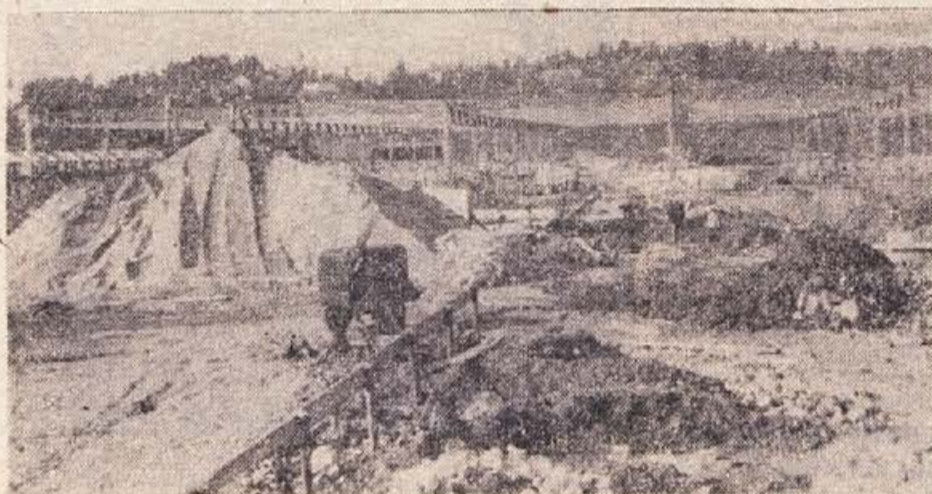
Novi objekti na gradbišču Kremenove steklarne v Bršljinu so že začeli dobivati pravo podobo. Po dolgotrajnih pripravljanih delih so že postavili kovinsko ogrodje razsežne proizvodne dvorane
