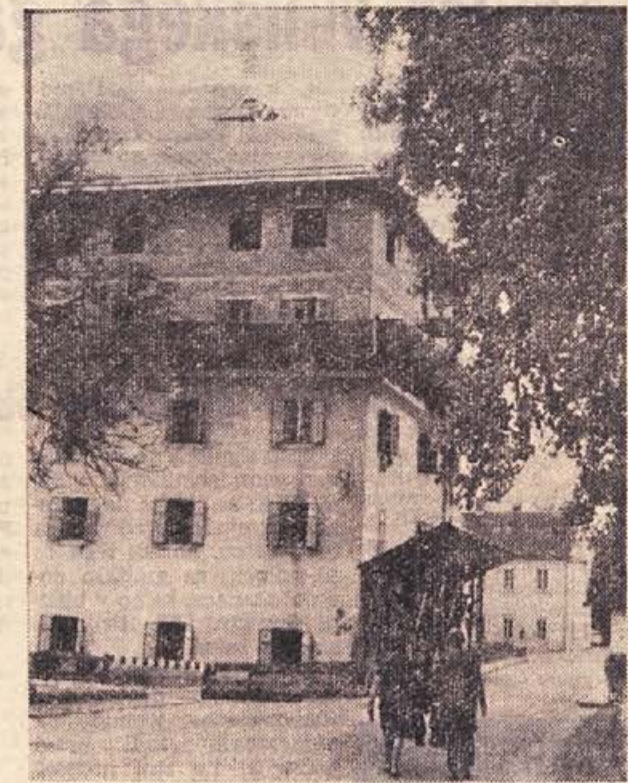
Gradbena dela na stavbi kopaliskega doma zdravilišča v Dolenjskih Toplicah so uspešno končana. V novi dve nadstropji stavbe, ki jo vidite na sliki, se bodo zdaj vselili obrtniki in postorili vse kar je treba, da bodo nove zmogljivosti čimprej na razpolago gostom.
