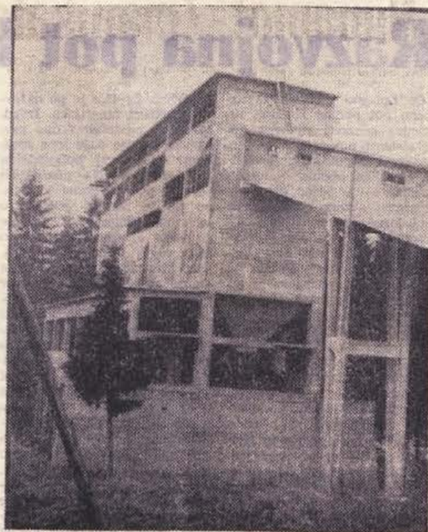
Pogled na vitko stavbo nove separacije v rudniku ... rica, ki se skriva med zelenjem smrek. Monterji hite z montažo strojnih naprav in upajo, da bodo v februarju 1963 gotovi
