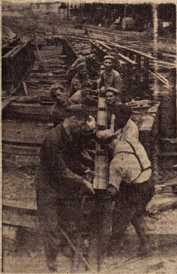
»Za večji, svetlejši in srečnejši novi dom« bi lahko rekli ob tem pogledu. Novi proizvodni obrat Metalne v Krmelju, dvorana iz kovinske konstrukcije, dolga 104 m in široka 18 m, bo kar hitro zrasla iz tal. Letos bodo sprejeli 13 vajencev, da bi si zagotovili dovolj kadrov. Metalna iz Maribora skrbi za naročila in za tržišče, tako da dela in kruha ne bo zmanjkalo. Na sliki: delavci zlagajo sestavne dele nove dvorane, ki jih sproti pripravljajo ob gradbišču. — Več berite o krmeljskih rudarjih in o slavnju prebivalcev sevniške občine, ki bodo jutri, 14. septembra, že desetletje slavili svoj občinski praznik, na 4. strani današnje številke.
