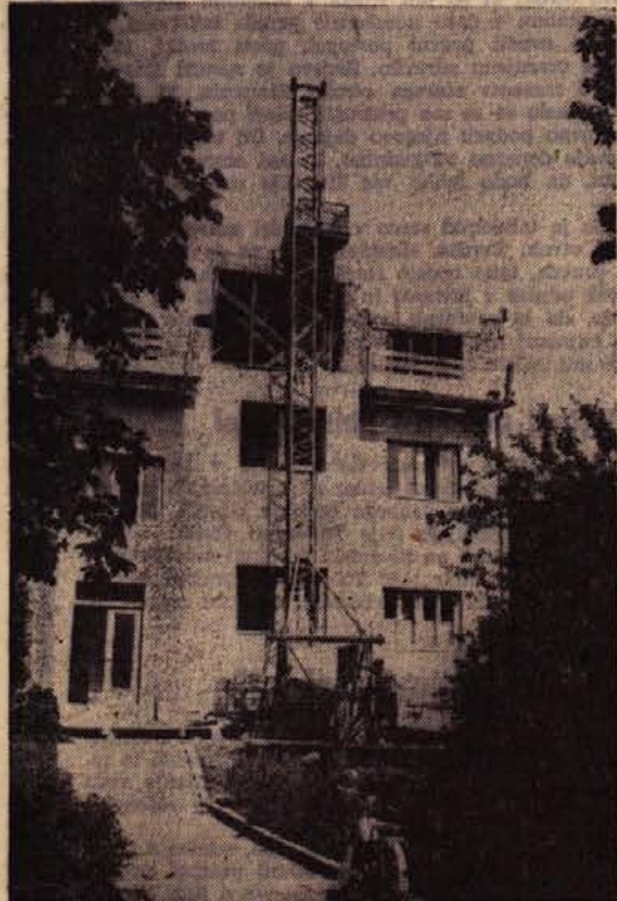
Zdravstveni dom v Crnomlju bodo povečali za eno nadstropje. Nadzidujeje z namenom, da bi navsezadnje le imeli vse zdravstvene prostore pod isto streho. Investitor del je zdravstveni dom sam.
