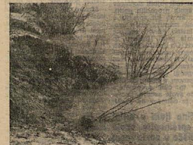
Zajeda, ki jo je naredila Sava na levem bregu malo pred izlivom Canjskega potoka. Potrebno bo hitro ukrepati, delo pa bo veljalo vsaj 2 milijona dinarjev, ker bo sicer Sava s povečevanjem zajedi ogrozila cestni in železniški most na Canjskem potoku
