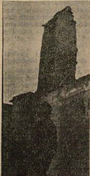
Iz tega dimnika se je razširil požar
