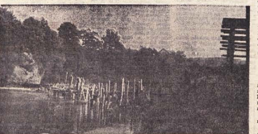
Slika kaže dela pri popravilu jezua na Krki v Novem mestu. Zaradi odprtín v jezui je Krka toliko upadla, da so bili iztočni kanali nad vodno gladino. Obnovitvena dela izvaja novomeška Komunala pod strokovnim nadzorom Vodne skupnosti. Če ne bo večjih padavin, bodo jez popravili do srede novembra. V ta namen bodo porabili 6 milijonov 200 tisoč din, gladina Krke pa bo za 60 cm višja. Večina iztočnih kanalov bo nato pod vodo. Ker bodo nekateri še nad vodno gladino, je treba že zdaj resno razmišljati o betonskem jezui s sistemom zapornic, ki bi dokončno rešil vprašanje vodnega stanja na Krki in kanalizacijskih izplak
